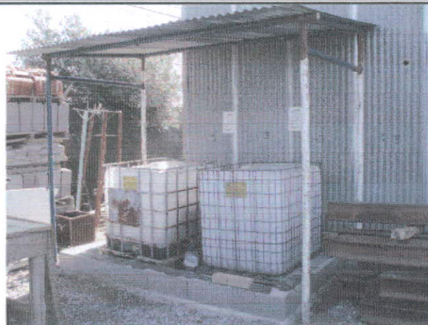
P8 Parque de Resíduos – Bacia de Resíduos Perigosos
